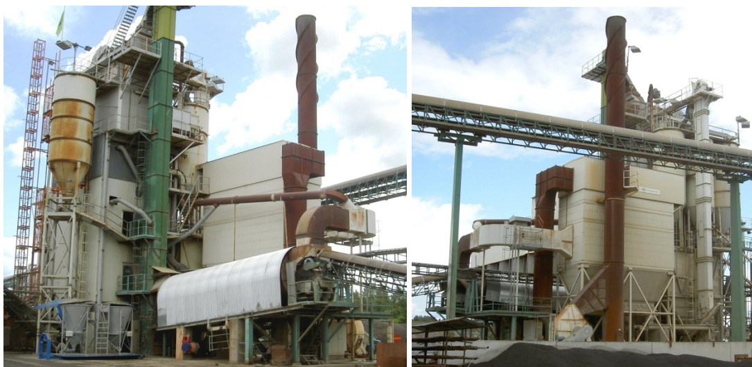
Bild 2. Ventilationskanaler går från flera utsug med damm, fukt och rökgaser till filteranläggningen för rening och recirkulering av fillern.
